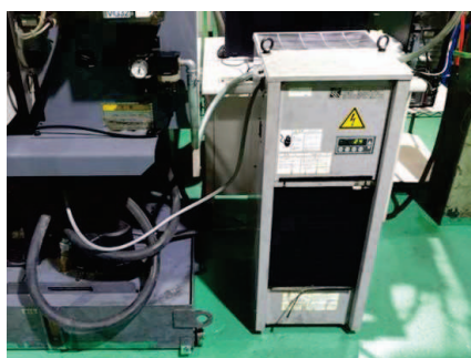
クーラントクーラー設置状態
